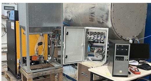
Vista de la caldera de biomasa, armario con la electrónica y ordenador de control. Dpto. de Ingeniería Mecánica. Grupo de Energía y CO 2 . EINA.
